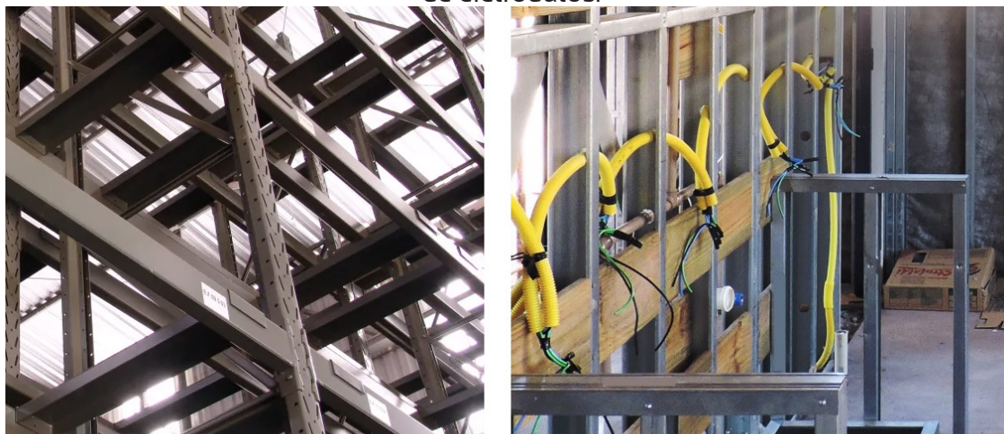
Figura 1 - Perfurações em perfis formados a frio: (a) para encaixe de ligações; (b) para a passagem de eletrodutos.
